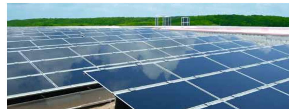
Eine Photovoltaikanlage auf dem Dach des Verteilzentrums in Weilerswist hilft bei der Einsparung von umweltschädlichem CO 2 .
